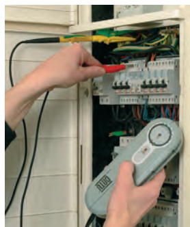
Contrôle d'isolement sur tableau domestique (installation hors tension) entre phase et terre avec le DT-500 (Réf. DT-500).
