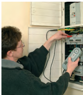
Contrôle d'isolement sur tableau entre phase/neutre et terre avec le DT-500 (Réf. DT-500).
