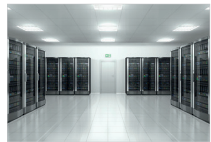
Fig. : Les process constants ou les applications sensibles comme les data centers sont basés sur la surveillance RCM.
